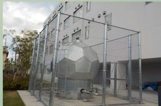
⑤ 貯水機能付給水管 断水時にも貯水分 (6,000ℓ) の水道水が 利用できます。
