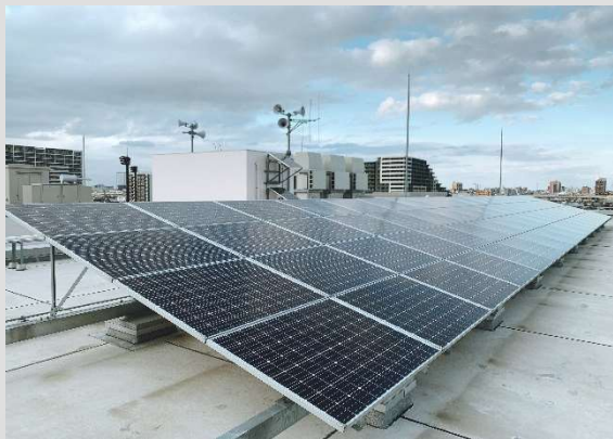
② 太陽光発電設備 屋上には20kwの太陽光発電設備があり、 教室約21室分、体育館、武道場の照明に 使用できます。
