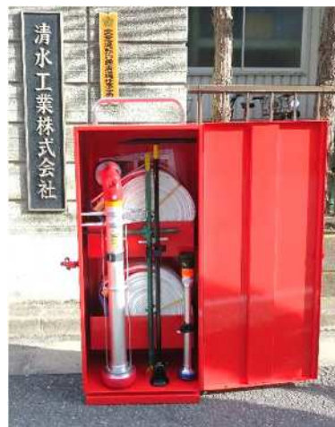
スタンドパイプ
