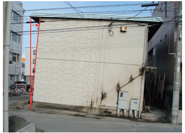
※建物が右側へ大きく沈下して傾いています。
