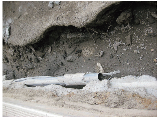
※建物周囲の地盤が下がり、配管が破損しています。
