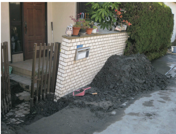
※道路とブロック塀の境目から出た噴砂が入口付近にたまっています。
