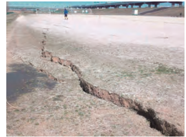
▲地割れが起こった木根川橋野球場
