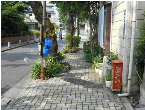
根上がりによって歩道の舗装が凸凹に
