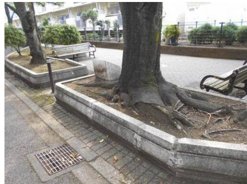
植栽樹が根によって破壊
