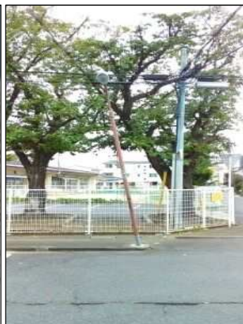
その他（灯柱傾き）
