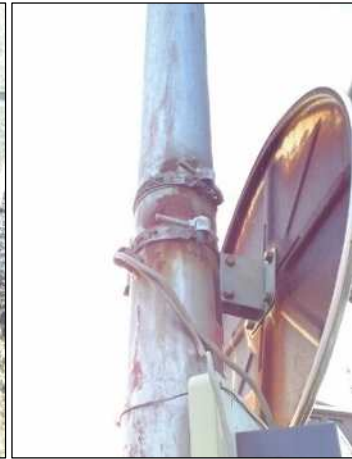
異種金属接触腐食
