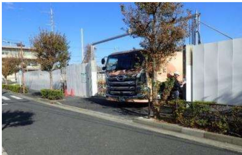
フラットパネル・出入口ゲート
