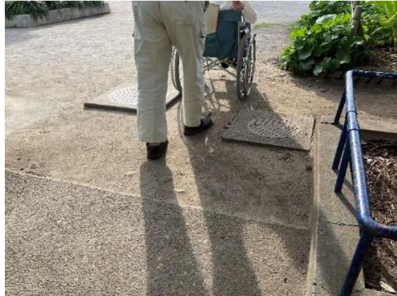
公園内の園路の段差
