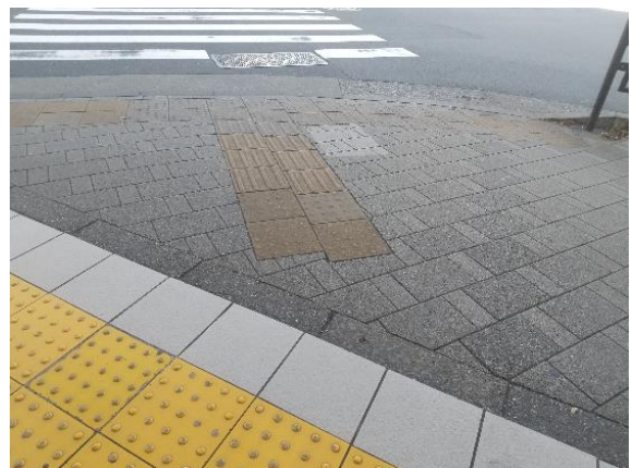
施設敷地（手前）と歩道（奥）で視覚障害者誘導用ブロックが繋がっていない
