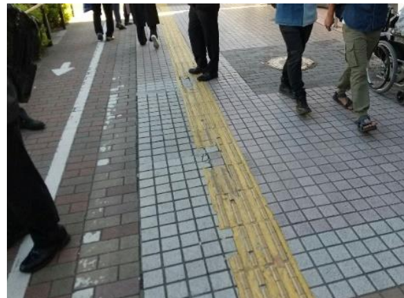
駅前広場における一部がはがれた 視覚障害者誘導用ブロック
